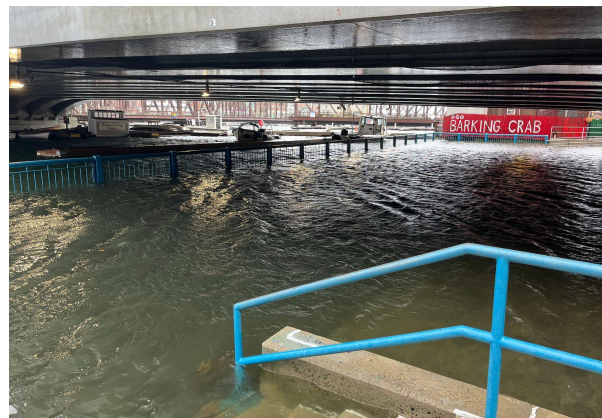
Inundason na fundu di Evelyn Moakley Bridge na Fort Point Channel, Sul di Boston (Fonti: Alison Brizius, Dezembru 2022)
